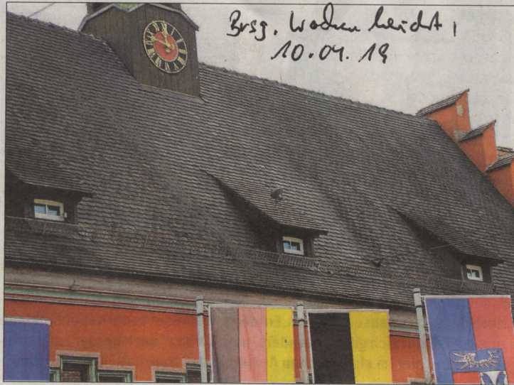
Sanierungsbedürftig ist auch das Rathausdach in der Innenstadt. 350.000 Euro sind als Haushaltsmittel eingestellt.
